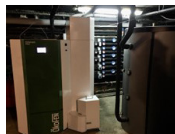
Chaudière pellet à l'hôtel du Vieux Puits (Meslan)
